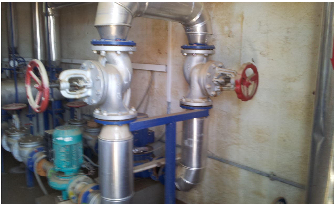
Slika 2. – Toplotna podstanica TP-61A
