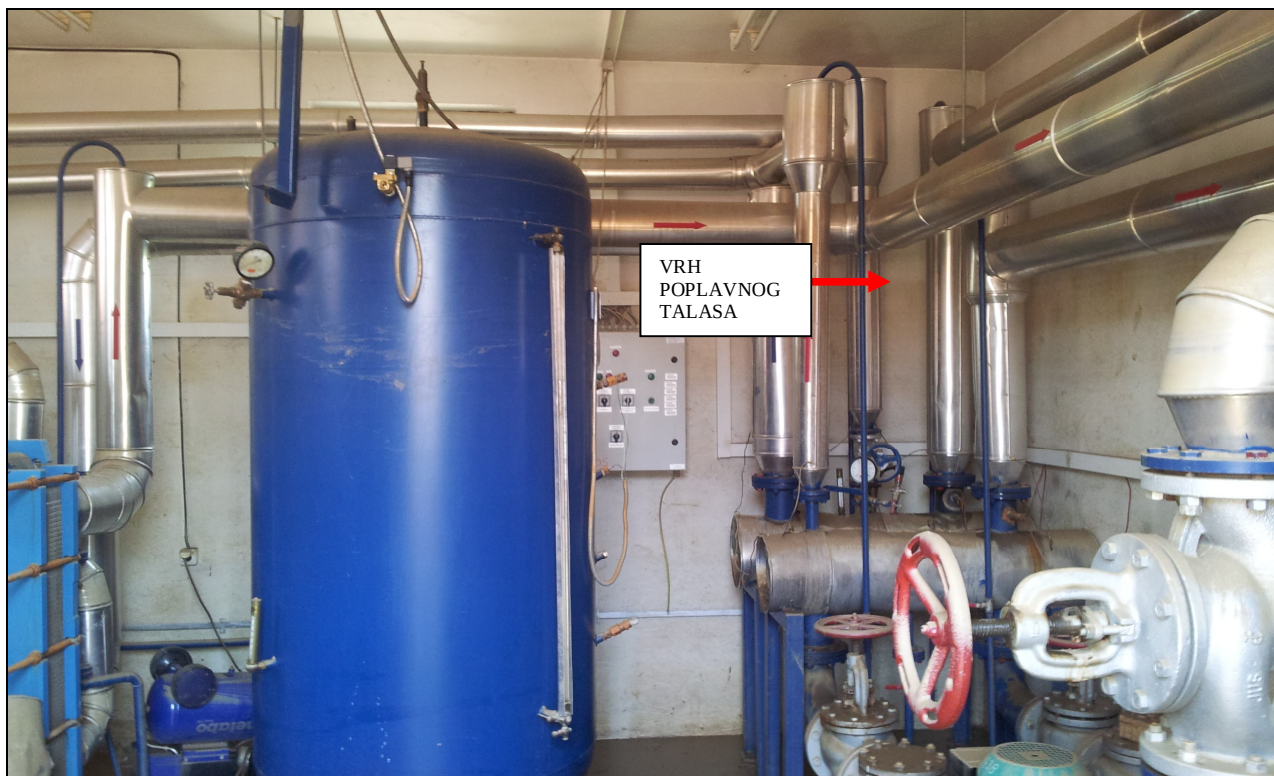
Slika 1. – Toplotna podstanica TP-61A
